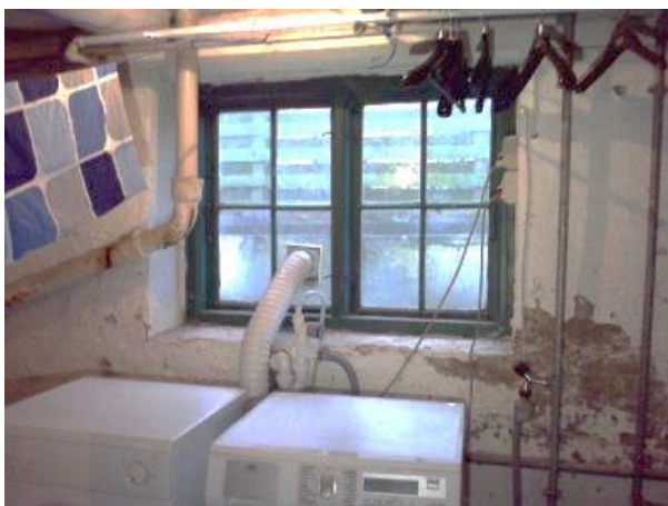
Eksempel på afskalling af sokkelen.
